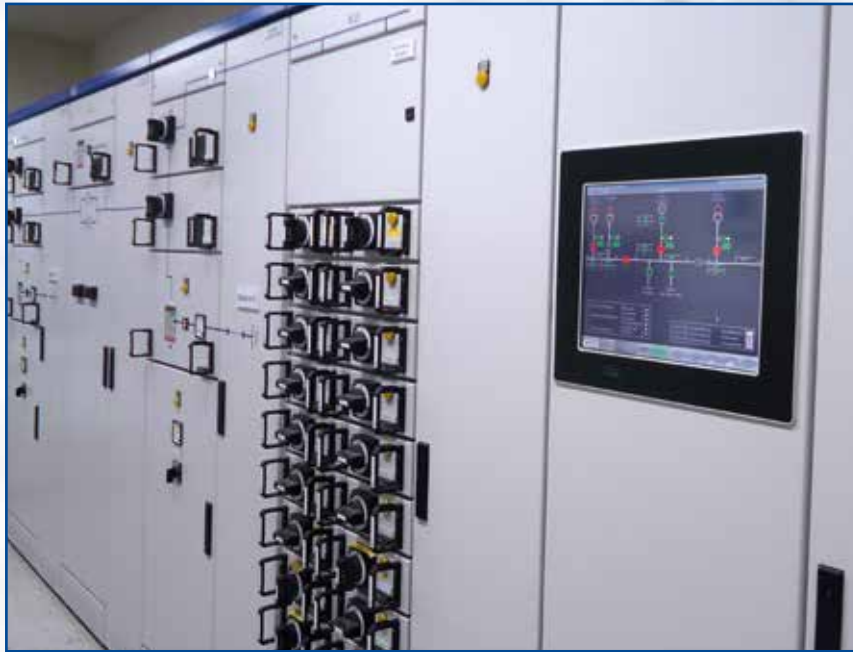
Umschaltautomatik für Eigenbedarfsverteiler: SPRECON-E-C
