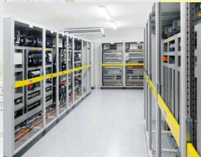
Der neu gestaltete Elektroraum mit Klimaanlage.
