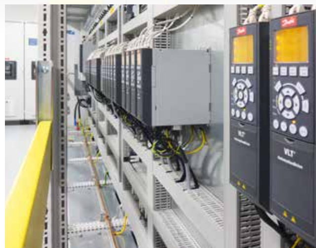
32 Frequenzumrichter sind Teil der neuen Anlage.
