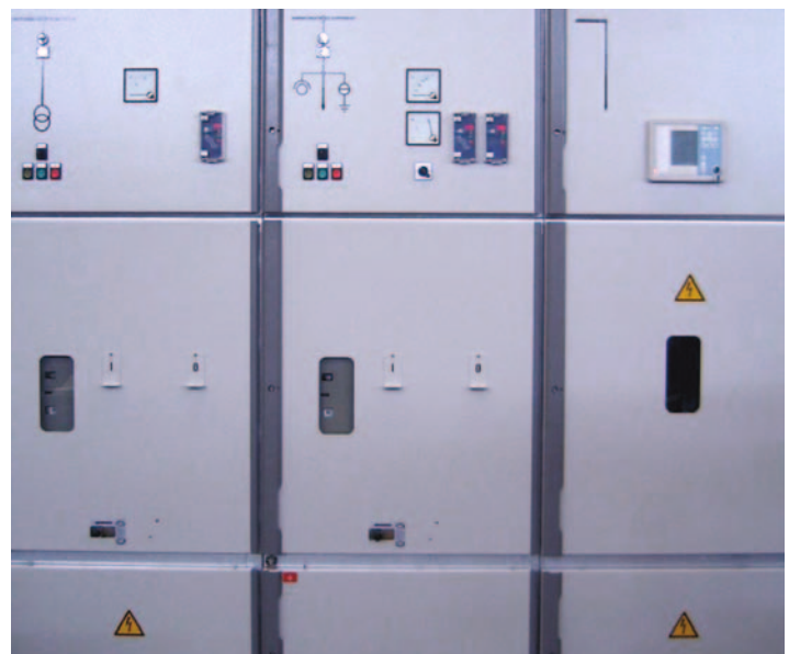
10 kV SPREPOWER Mittelspannungsschaltanlage
